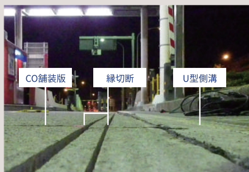
施工前：CO舗装版とU型側溝共に沈下
