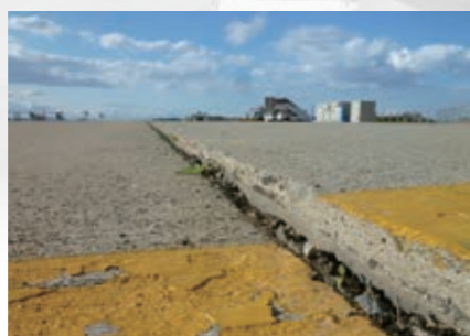
空港エプロンに出来た段差
