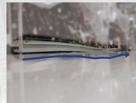
地盤沈下でたわんでしまった床により、商品のラックがたわんでしまった状態
