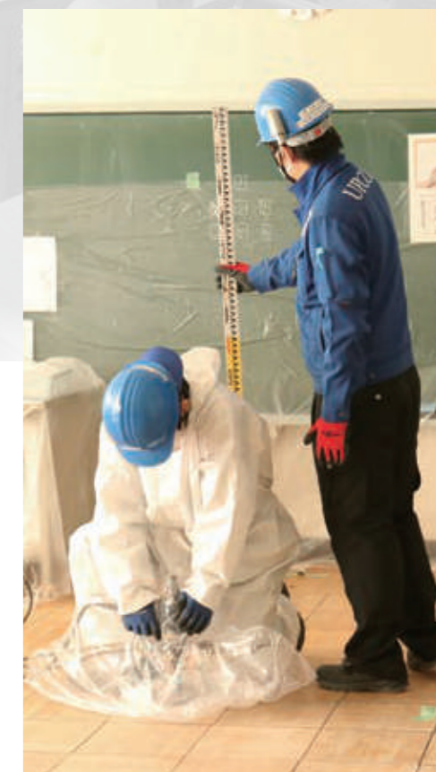
たわんだ床の沈下修正は一般的な教室の広さなら1日で施工が可能
