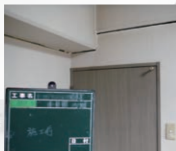
壁と天井の間に隙間が発生
