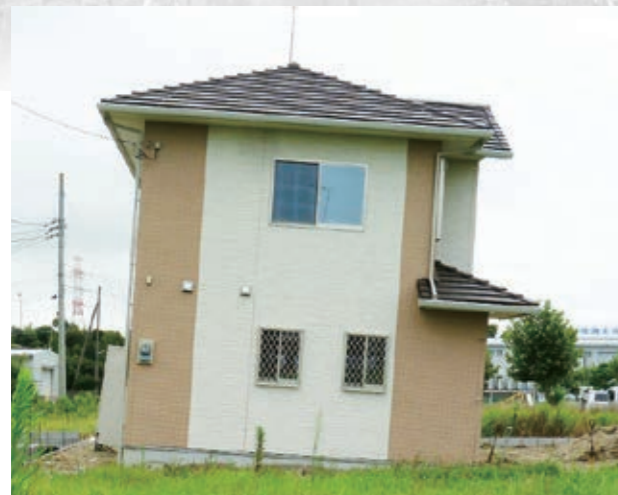
地震による液状化のため大きく沈下してしまった住宅
